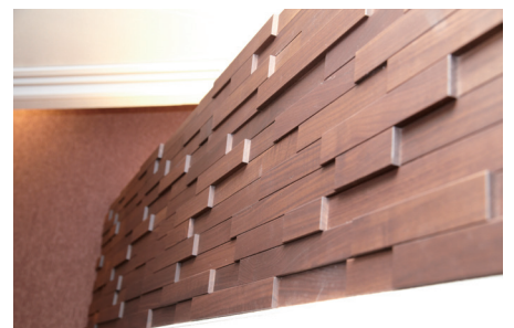
スタジオの壁面。音響設計は株式会社アコースティックエンジニアリング、施工は有限会社安田テクニカルビルドが担当した
