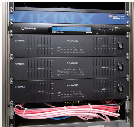
マシン・ルームに設置された「Nuendo SyncStation」と3台の「Nuage I/O 16D」。1台でデジタル16ch入出力という仕様で、コントロール・ルーム設置の「Nuage I/O」を加えると計64ch入出力。Danteのデジタル・オーディオ伝送によって、ホスト・コンピューターや「DME64N」とのルーティングを実現している
